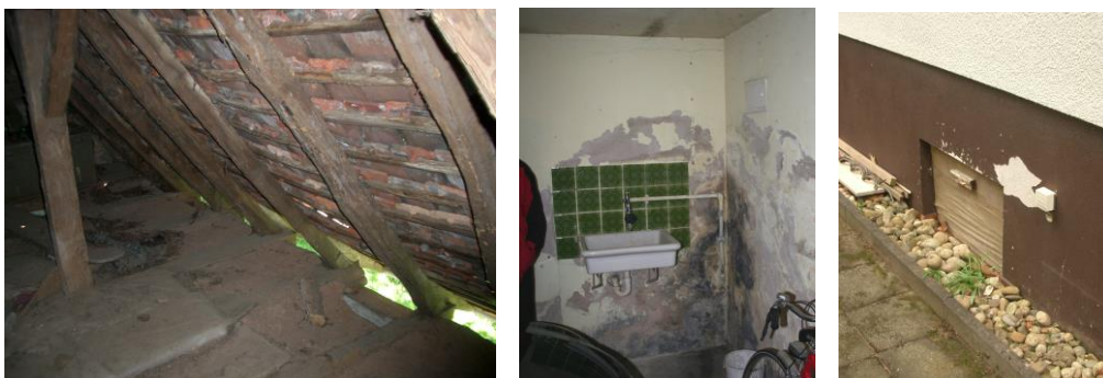
Schäden an der Gebäudehülle, die im Rahmen einer Energieberatung mit aufgenommen werden.
